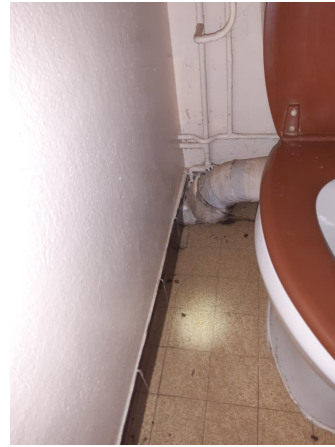
déclaré - : Rez de Chaussée / Salle d'eau + wc - Conduit - EP- (Présence d'amiante)
