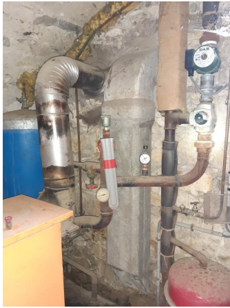
Déclaré - : Sous Sol / Cave - Conduit - EP- (Présence d'amiante)
