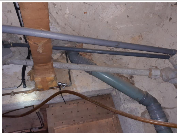
Déclaré - : Sous Sol / Palier - Conduit - EP- (Présence d'amiante)
