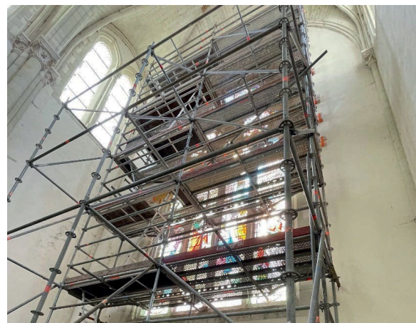
Vitrail ouest : Chute d'un élément structurant du vitrail ouest. Prévention de la chute du vitrail par la mise en place d'un échafaudage intérieur.
