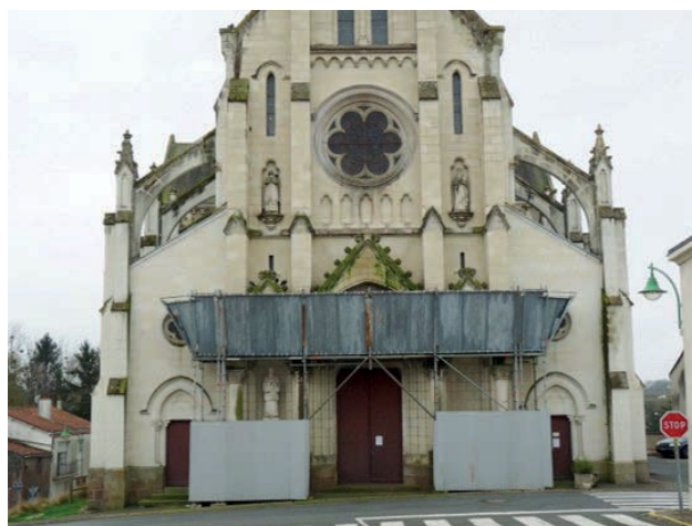
Façade nord : Dégradation des parements en tuffeau. Prévention des chutes de pierres par la mise en place d'un échafaudage.
