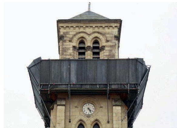
Clocher : Dégradation des jointements d'éléments structurants du clocher. Prévention de la chute de pierres par la mise en place d'un parement en tôle.
