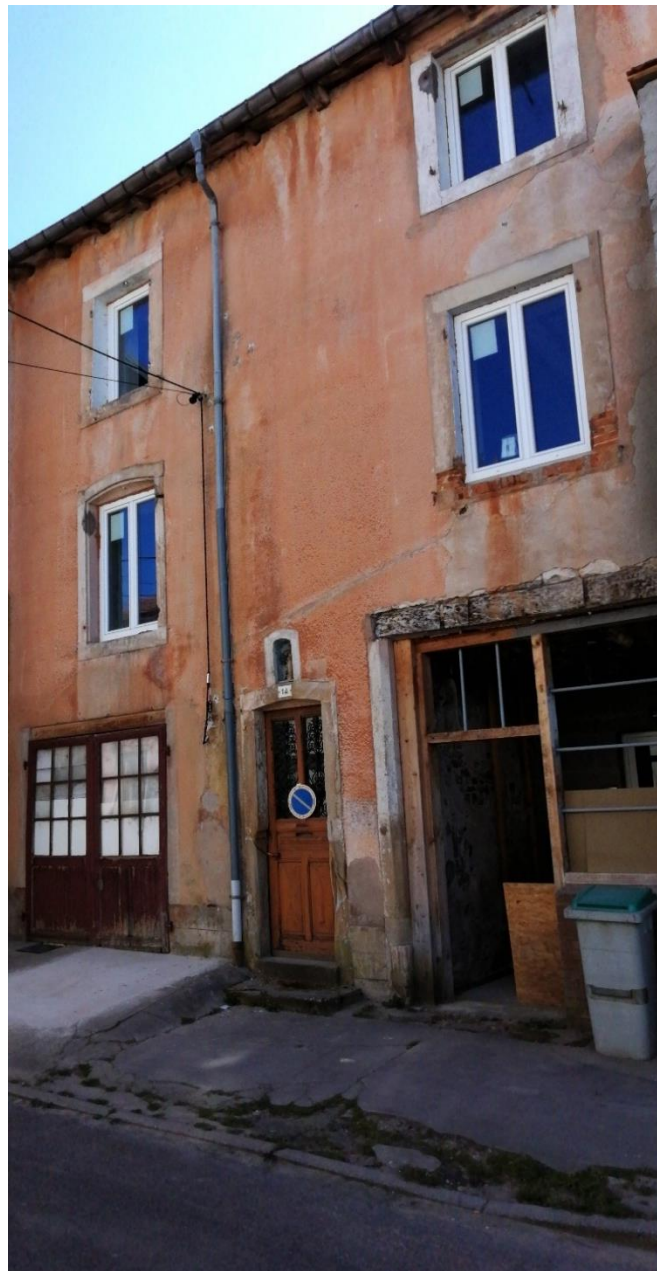
14 rue du 11 Novembre 1918 – Bâti très dégradé et vacant
