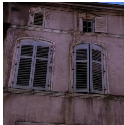
43 Rue Maurice Barrès – Problèmes d'étanchéité
