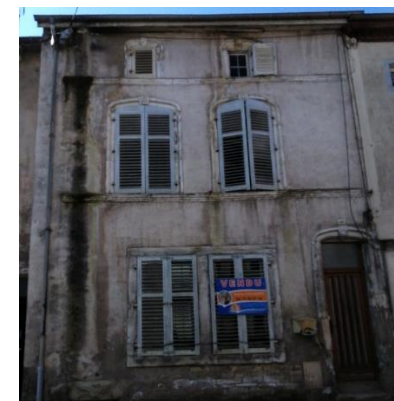
43 Rue Maurice Barrès – Problèmes d'étanchéité
