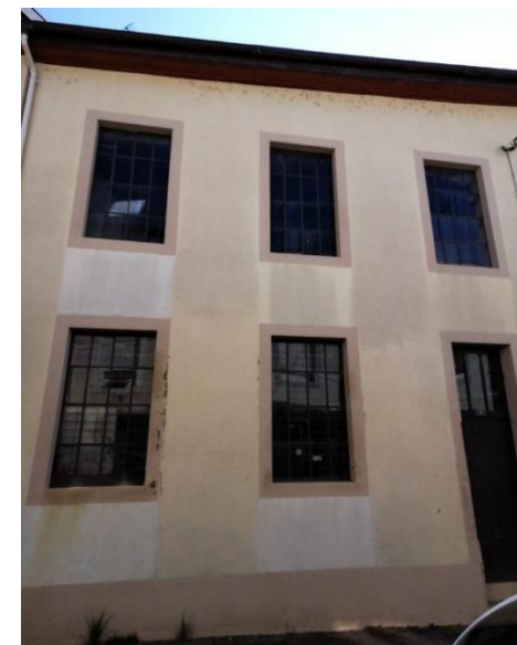
8 Rue de la République – Intérieur dégradé visible depuis l'extérieur
