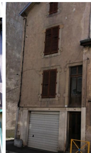
6 Rue de Madagascar : risque de chutes depuis la porte à l'étage
