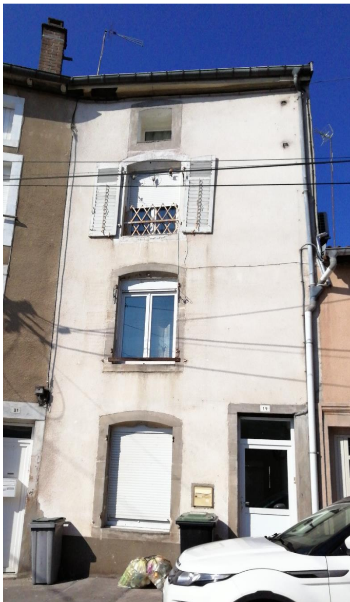
19 Rue de la République – Bâti dégradé : garde-corps qui représente un risque, corniches et menuiseries
