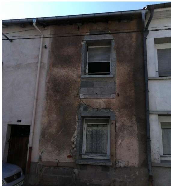
2 rue des Fausses de la Ville – Bâti très dégradé et vacant
