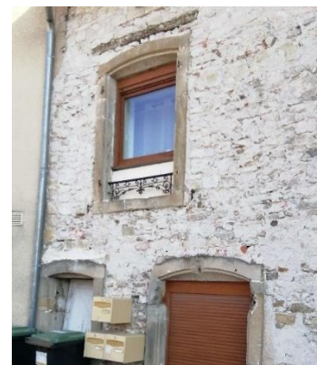
70 Rue Maurice Barrès – Problèmes d'isolation (pierres apparentes)
