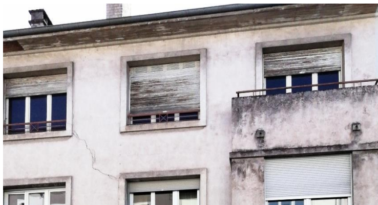
12 Rue de Madagascar – Bâti cumulant des dysfonctionnements : corniche et menuiseries en mauvais état, humidité et fissures sur la façade
