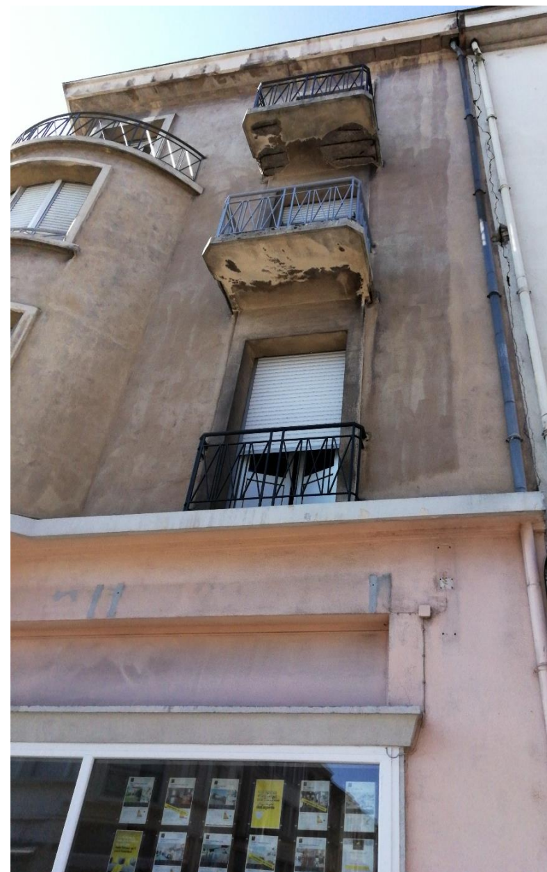
1 Rue de la République – Bâti qui présente des éléments structurels dégradés : les sous-faces des balcons, 2 logements vacants y sont recensés
