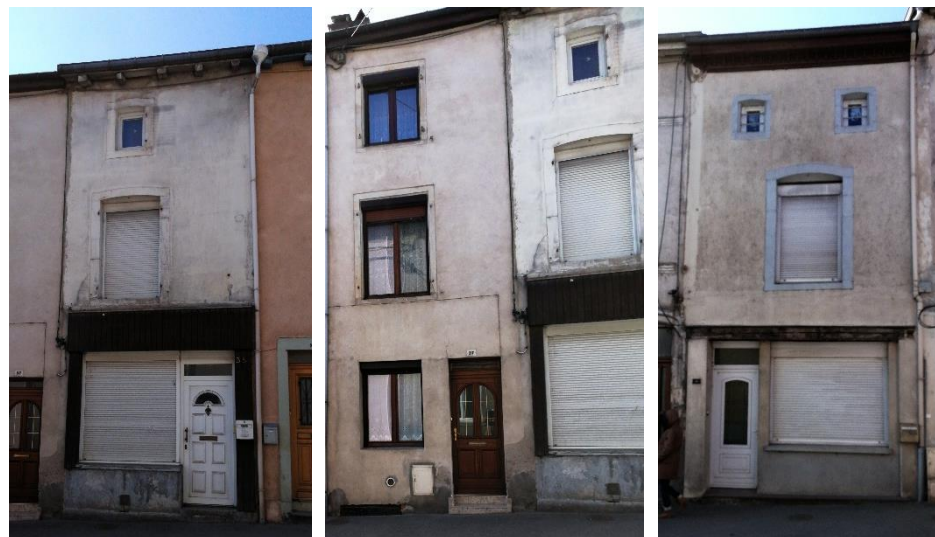
Rue Maurice Barrès : Des garde-corps manquants
