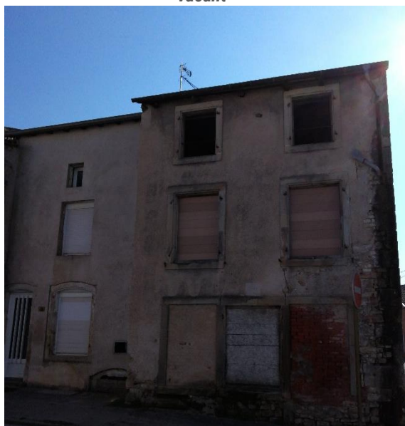
20 rue de la République – Bâti très dégradé et vacant
