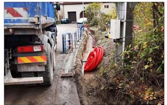
Les travaux d'enfouissement des réseaux secs se poursuivent dans la rue du Prailly à Dombrot-le-Sec.
