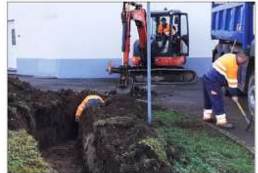
Les travaux d'enfouissement du réseau électrique se poursuivent au niveau de la rue Louis-Aubry.
