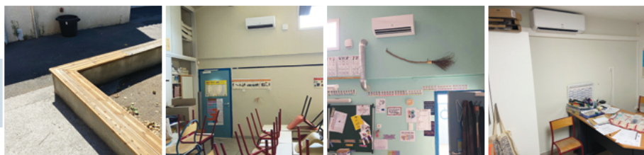
ÉCOLE DE LA LIBERTÉ — Réparation banc cour — Pose des clim dans deux classes, la salle des maîtres, et le bureau de la directrice. Tout est équipé!
