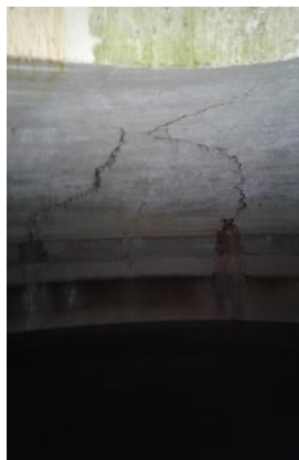
Fissures sur le dôme de la cuve
