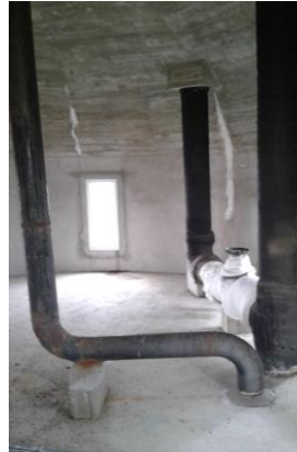
Canalisations de remplissage et de distribution
