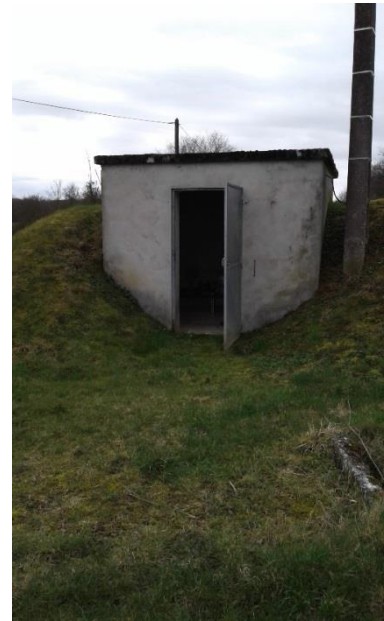
Figure 32 : Entrée station de surpression des Fauchots
