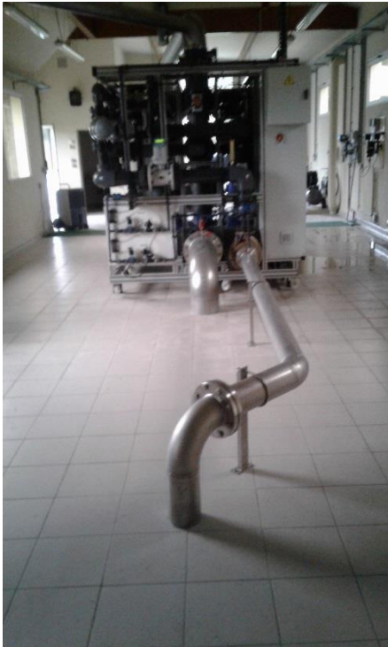
Figure 10 : Equipement ultrafiltration par membranes
