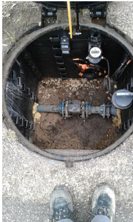
Figure 53 : Débitmètre sectorisation Rue des Presles
