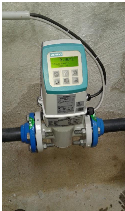
Figure 47 : Débitmètre surpresseur des Pierrons
