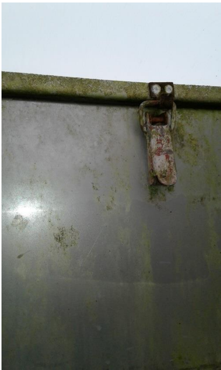
Figure 26 : Trappe d'accès au toit corrodée
