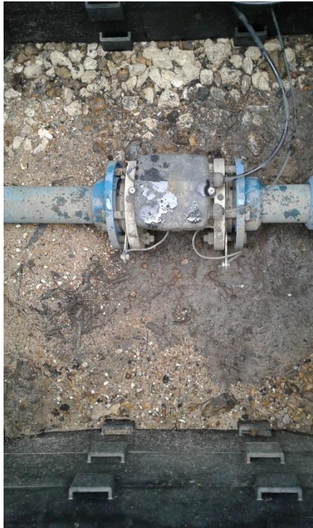
Figure 50 : Débitmètre sectorisation Rue des Mottes
