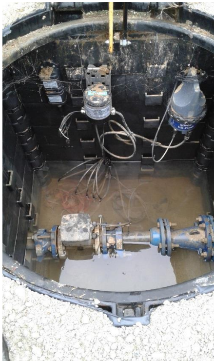
Figure 51 : Débitmètre sectorisation la Chailloterie
