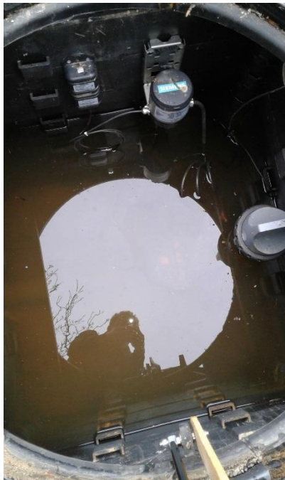
Figure 54 : Débitmètre distribution RT Montcorbon
