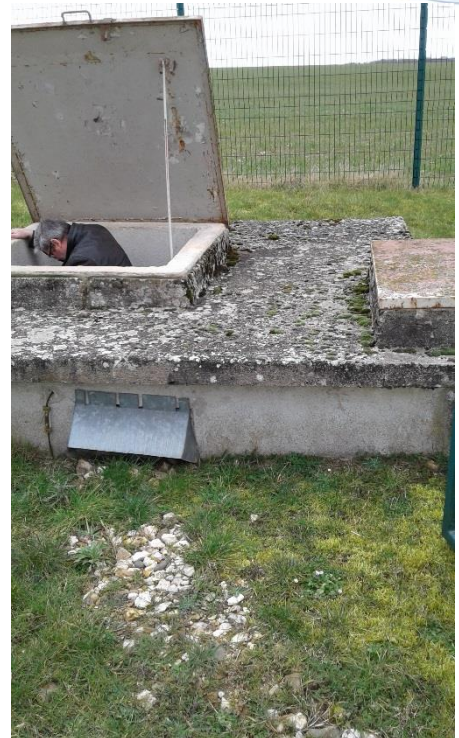
Figure 37 : Entrée station de surpression les Pierrons
