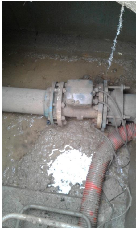
Figure 48 : Débitmètre sortie réservoir sur tour Douchy vers Douchy
