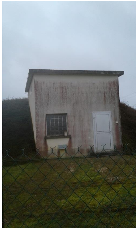
Figure 11 : Réservoir semi-enterré de Douchy
