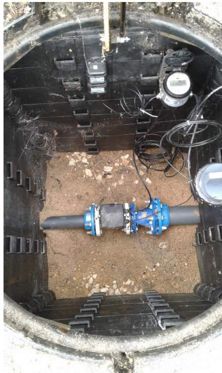
Figure 52 : Débitmètre sectorisation Rue Christian Fouliol
