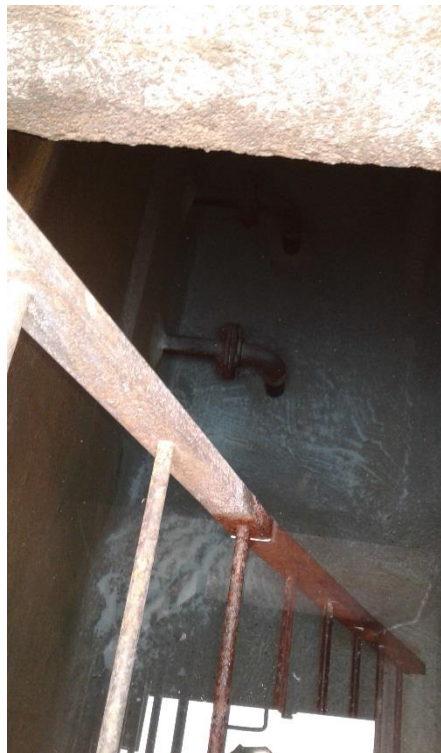
Figure 40 : Bâche de stockage du relais Montcorbon
