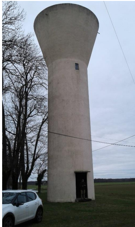
Figure 16 : Réservoir sur tour de Montcorbon
