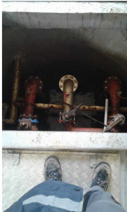
Figure 5 : Pompes d'exhaure du captage
