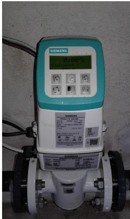
Figure 46 : Débitmètre surpresseur des Fauchots
