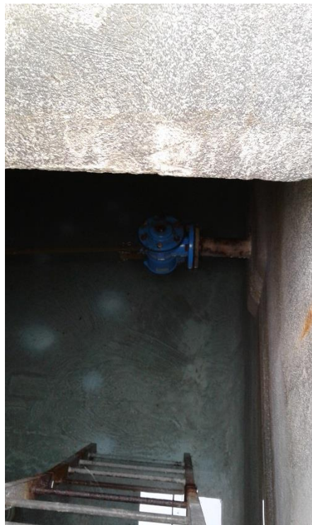
Figure 38 : Bâche surpresseur les Pierrons
