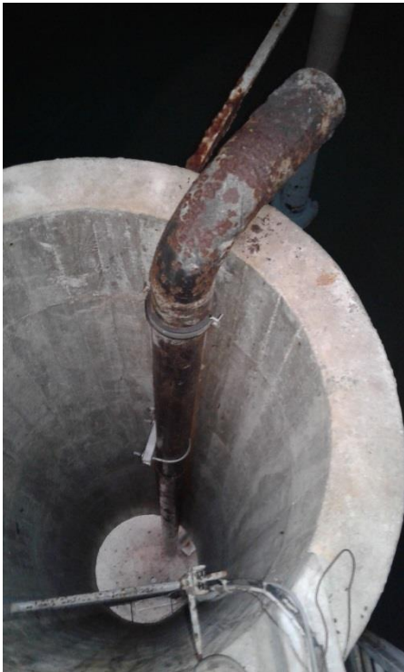
Figure 24 : Canalisation de refoulement
