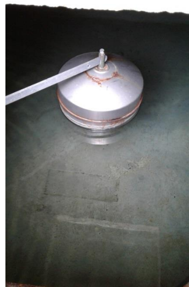
Figure 34 : Bâche surpresseur des Fauchots
