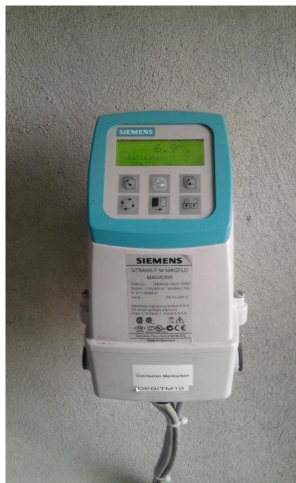
Figure 49 : Afficheur débitmètre sortie réservoir sur tour de Douchy vers Montcorbon
