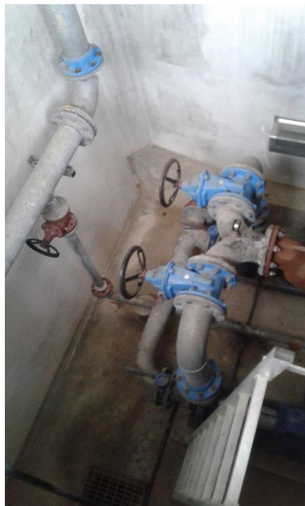
Figure 13 : Equipements du réservoir semi-enterré
