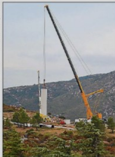
La dernière éolienne.
