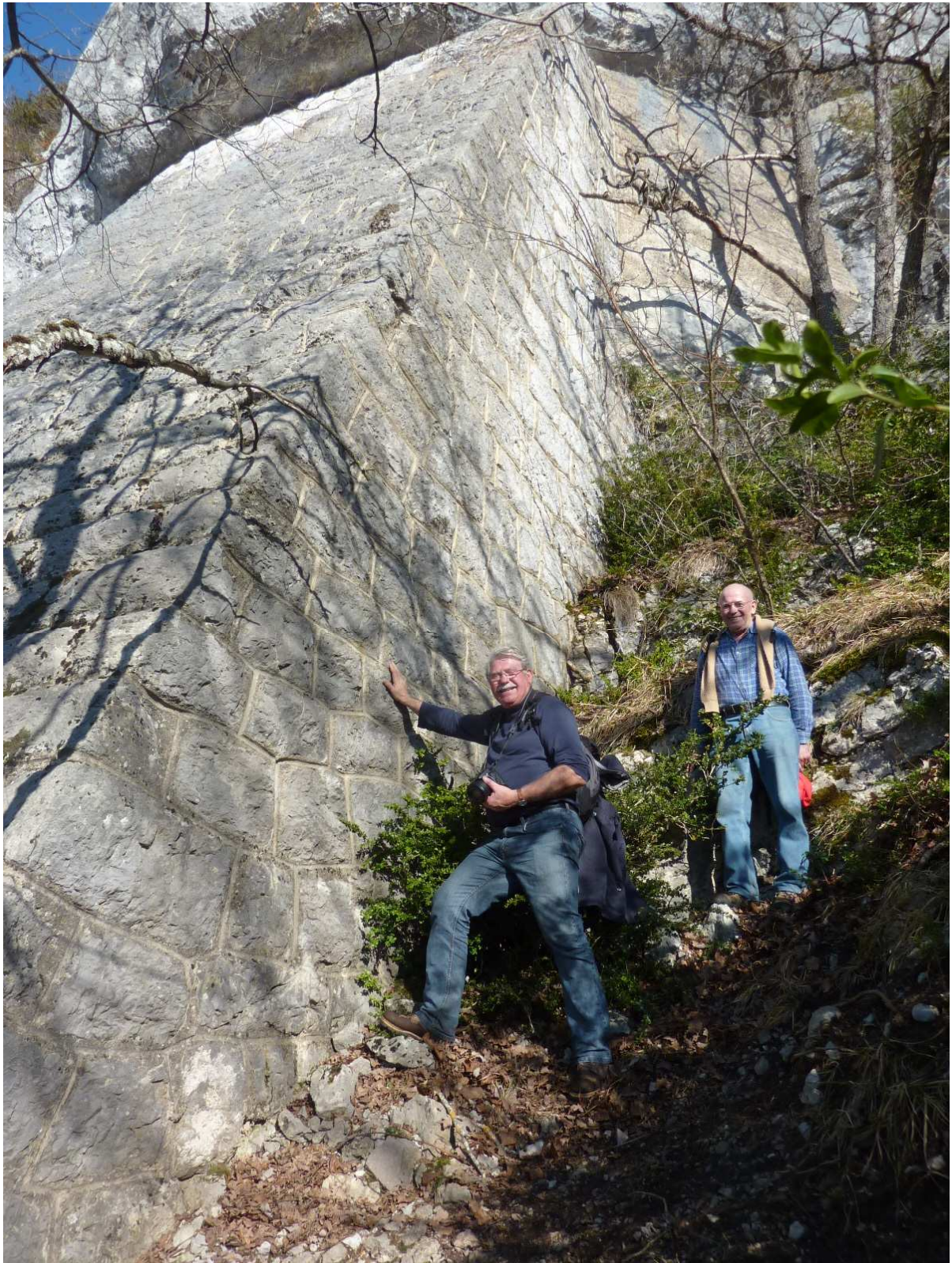
Le mur de soutènement cent ans après sa construction. Tenue parfaite de la maçonnerie.
