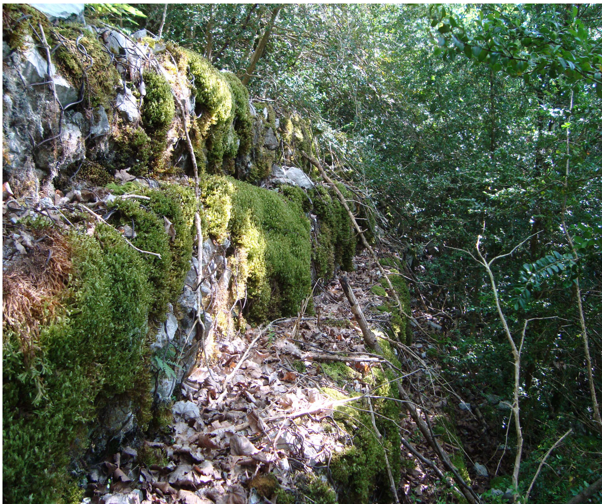
Gabions édifés en 1913 pour fixer les produits de l'explosion du rocher. Ils sont aujourd'hui couverts de buis et de taillis.
