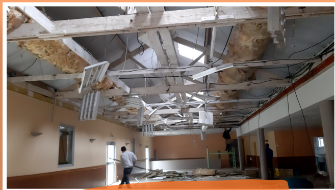
Gaines de ventilation sous plafond
