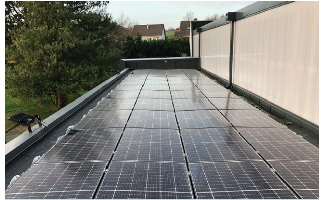
La toiture de la salle Albert Camus est équipée de panneaux photovoltaïques pour la production d'énergie renouvelable.
