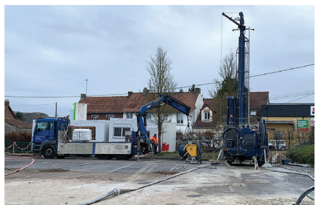
La géothermie montre de très bons rendements sur la Maison de santé du Pays de Lumbres ouverte récemment.
