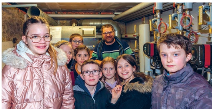
Visites des chaufferies communales
