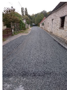
Réfection sur un côté du chemin de Prédecelle, de l'Allée de la Colombe et du chemin des Goélands.
