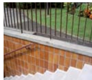
▲ Ici la main courante doit être prolongée jusqu'à la verticale de la première marche. Première et dernière marches seront peintes de façon contrastée pour permettre à des mal voyants d'emprunter le souterrain.
