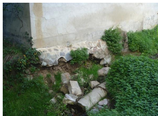
Effondrement d'un pied de mur (bâtiment) à Valeille en aval du pont de la D18
