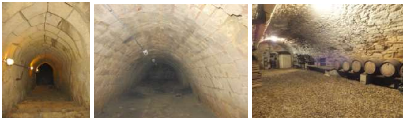
Les caves sous la propriété de Monsieur et Madame François MARTIN, au pied du Mont Pigeon
