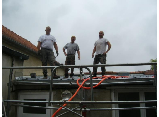
Les travaux de couverture et d'isolation sur le toit de la salle des fêtes
