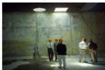
Bassin enterré visitable
