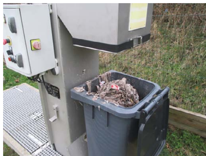
Récupération des déchets à l'entrée d'une station de traitement des eaux usées
