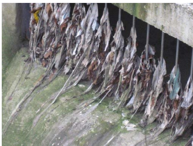
Lingettes obstruant une grille du réseau
