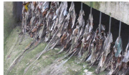
Lingettes obstruant une grille du réseau
