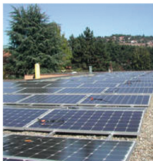
Panneaux solaires photovoltaïques de l'école publique des Ollières à l'ETRAT - SIEL
