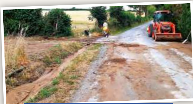
Curage des fossés Route de la Gimond suite à un violent orage
