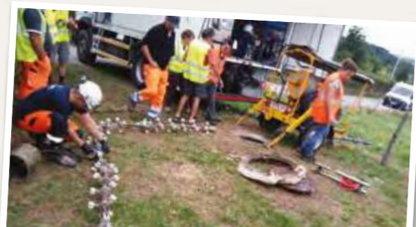
Visite sur site avec les élus, le personnel communal d'Avezieux et les techniciens de CCFE. On peut voir le train de lampes UV qui sert à insoler la gaine pré-enduite
