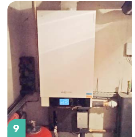
9 < CHAUDIÈRE DE LA POLICE > Remplacement de la chaudière à la Police par celle qui a été récupérée à l'ancienne caserne des Pompiers.
