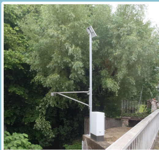
Station de mesures sur le Bion à Bourgoin-Jallieu
