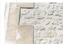
L'enduit aurait du recouvrir les moellons et se raccorder exactement au niveau des encadrements en pierre de taille.
