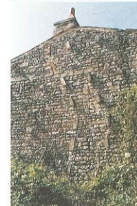
Conduit de cheminée tordu
