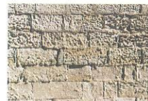
On voit souvent des pierres "malades" dans les vieux murs.
