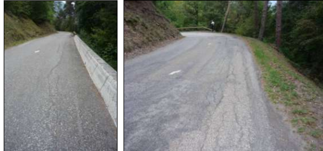
Figure 4 : Fissures sur la moitié aval de la RD 88 [Source : IMS RN ]
