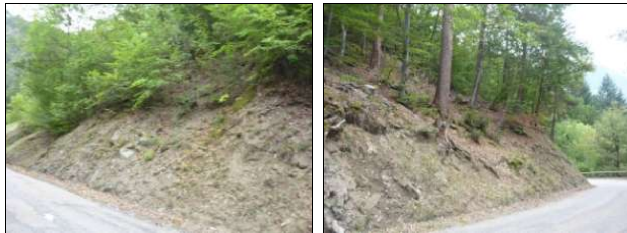
Figure 5 : Talus instables en bordure de la RD 88 [Source : IMS RN ]
