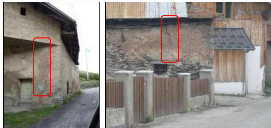
Figure 5 : Fissures sur certaines constructions dans le village [Source : IMS RN ]
