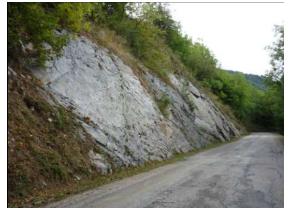
Figure 3 : Couche de schistes présentant un pendage dans le sens de la pente, en bordure de la route menant au chef-lieu. A noter la présence de désordres (fissuration) sur la chaussée, preuve de l'instabilité du versant [Source : IMS RN ]
