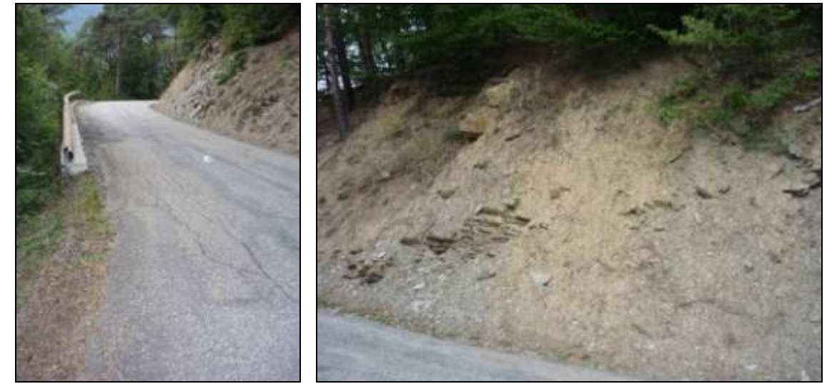
Figure 6 : Fissures sur la moitié aval de la RD 88 [Source : IMS RN ]
