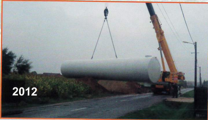
Citerne incendie 60 m 3 Rue du Choquart
