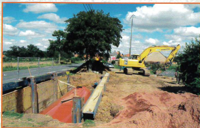
Citerne incendie 60 m 3 à Crecques
