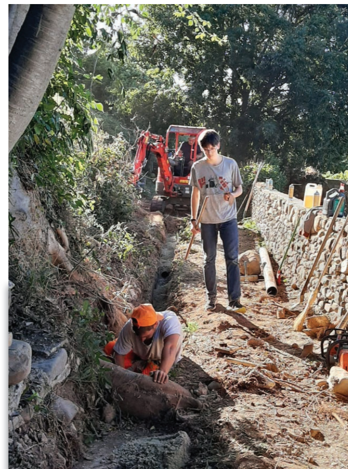
Pour venir en aide aux riverains des jardins, l'équipe technique a réalisé la réhabilitation de l'alimentation en eau. Les travaux ont été effectués tout au long du chemin desservant ces jardins.
