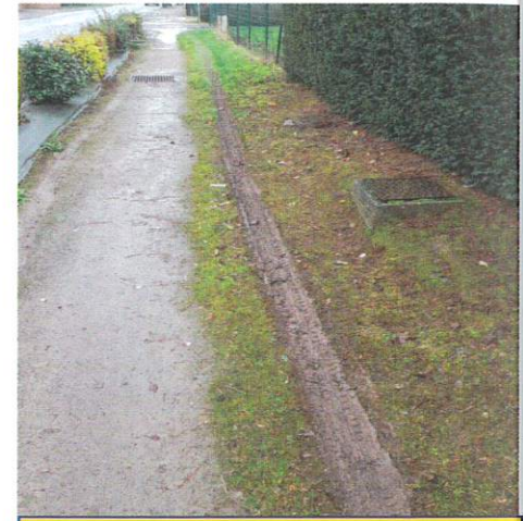
Traces de pneus sur l'accotement piétonnier sur plus 300 mètres
