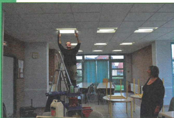
TRAVAUX DE REMISE EN ETAT DE LA SALLE DU MILLENNIUM (PEINTURES, RIDEAUX, NETTOYAGE EXTERIEUR, REPARATION MATERIEL CUISINE)
