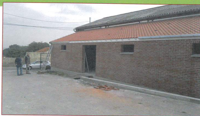
AGRANDISSEMENT DE LA SALLE PAROISSIALE POUR Y CRÉER UN LOCAL DE RANGEMENT ET DES TOILETTES
