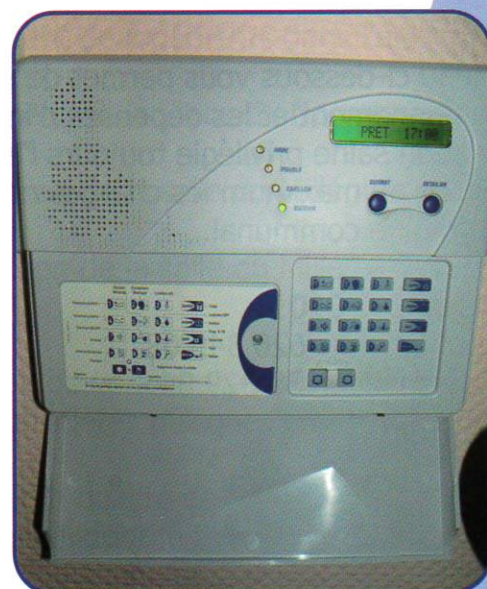
Pose d'alarmes à la salle du Millénium et dans les services techniques de la commune et du syndicat des eaux
