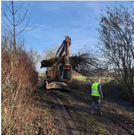
↑ Plusieurs souches et troncs empêchaient le bon ruissellement du Lissgraben
