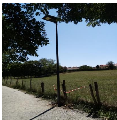
Éclairage du chemin du stade
