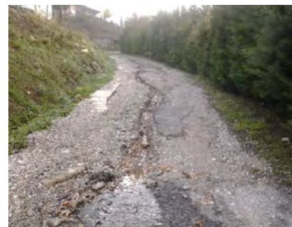
Dégradation de route, Tempête Gloria janvier 2020 ©Mairie de Coustouges
