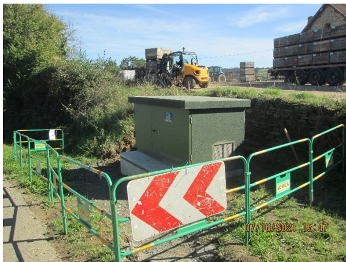
Ci-dessus : APRES travaux – transformateur cabine basse
