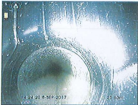
Photo: 8_8_19_A.BMP 26m, Fin de l'inspection RV N° REU5
