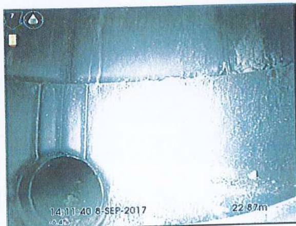
Photo: 6_6_13_A.BMP 23m, Fin de l'inspection RV N° REU7
