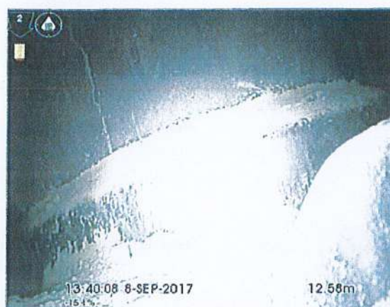
Photo: 2_2_4_A.BMP 13m, Fin de l'inspection RV N° REU11
