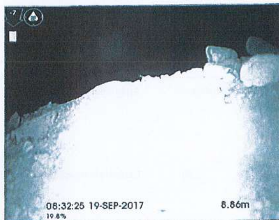
Photo: 4_4_36_A.BMP 9m, Fin de l'inspection RV N° REU10
