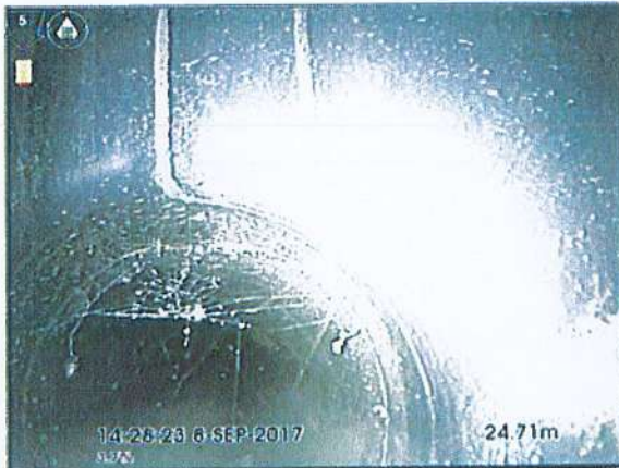
Photo: 9_9_24_A.BMP 25m, Fin de l'inspection RV N° REU4
