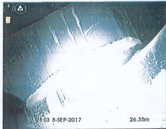
Photo: 1_1_2_A.BMP 27m, Fin de l'inspection RV N° REU12
