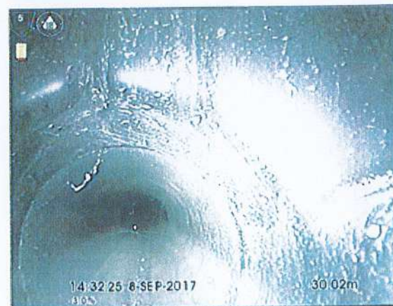
Photo: 10_10_28_A.BMP 30,5m, Fin de l'inspection RV N° REU3
