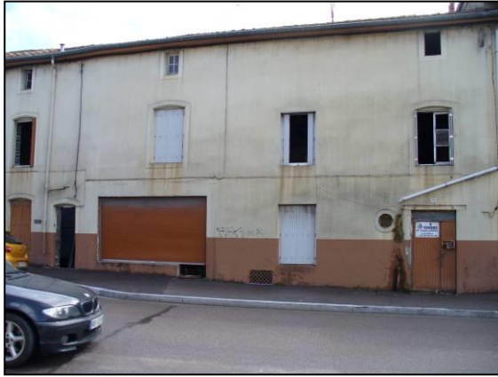
Logement à vendre : vacant : manque d'entretien visible, interrogation sur le coût de la rénovation....
