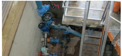
Chambre des vannes du réservoir d'Espeluche, à partir duquel le réservoir de Montboucher sur Jabron est alimenté avec comme secours le réservoir de Rotary.
