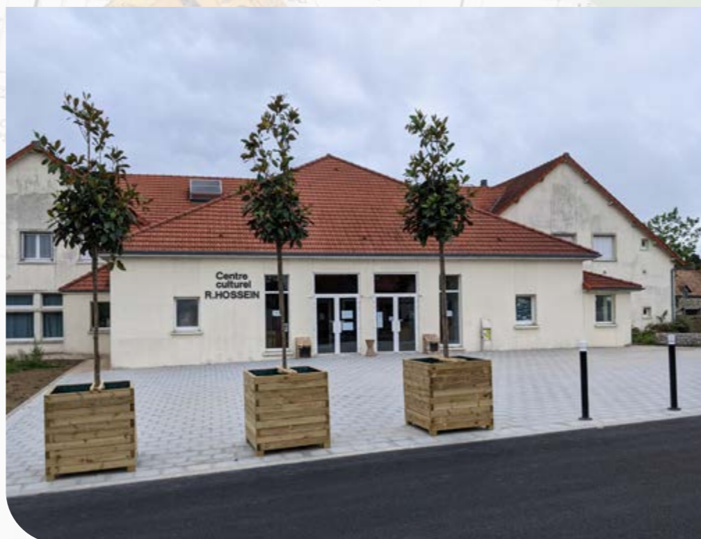
Rénovation et extension du parvis et du parking du Centre Culturel Robert Hossein
