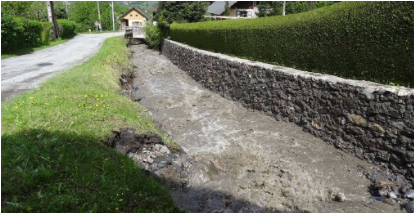
Figure II.9: Lit en amont du pont communal à la fin de la crue de 2015.
