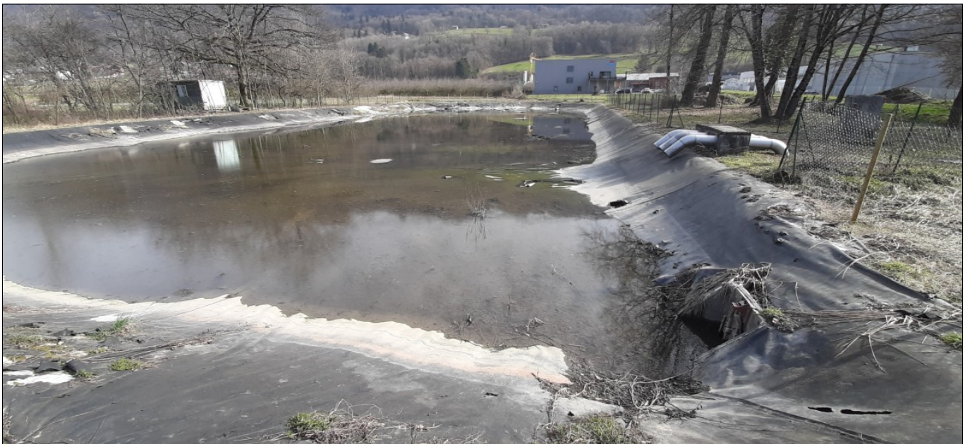
Figure III.5: Bassin d'orage de la ZAC.
