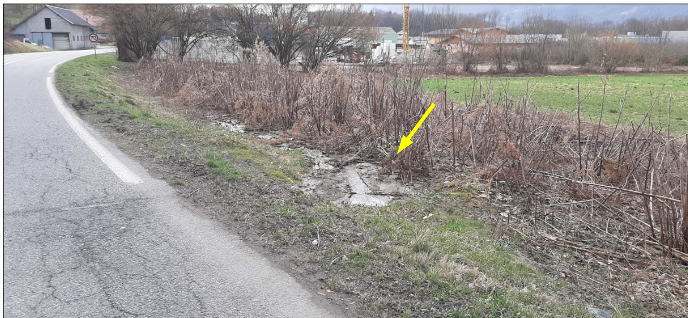
Figure III.10: Divagation des eaux à l'aval de la RD 925 en sortie de buse et développement de Renouée du Japon.
