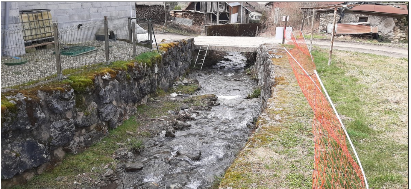
Figure II.19: ponceau d'accès à Viplanne de section insuffisante et brèche dans la protection rive gauche.
