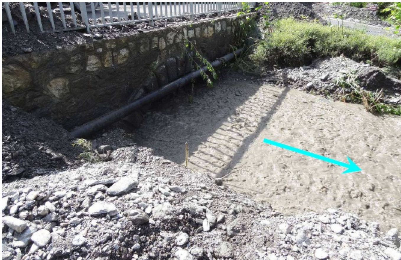
Figure II.12: Engravement du pont de la RD 925 vu depuis l'aval, en 2015.
