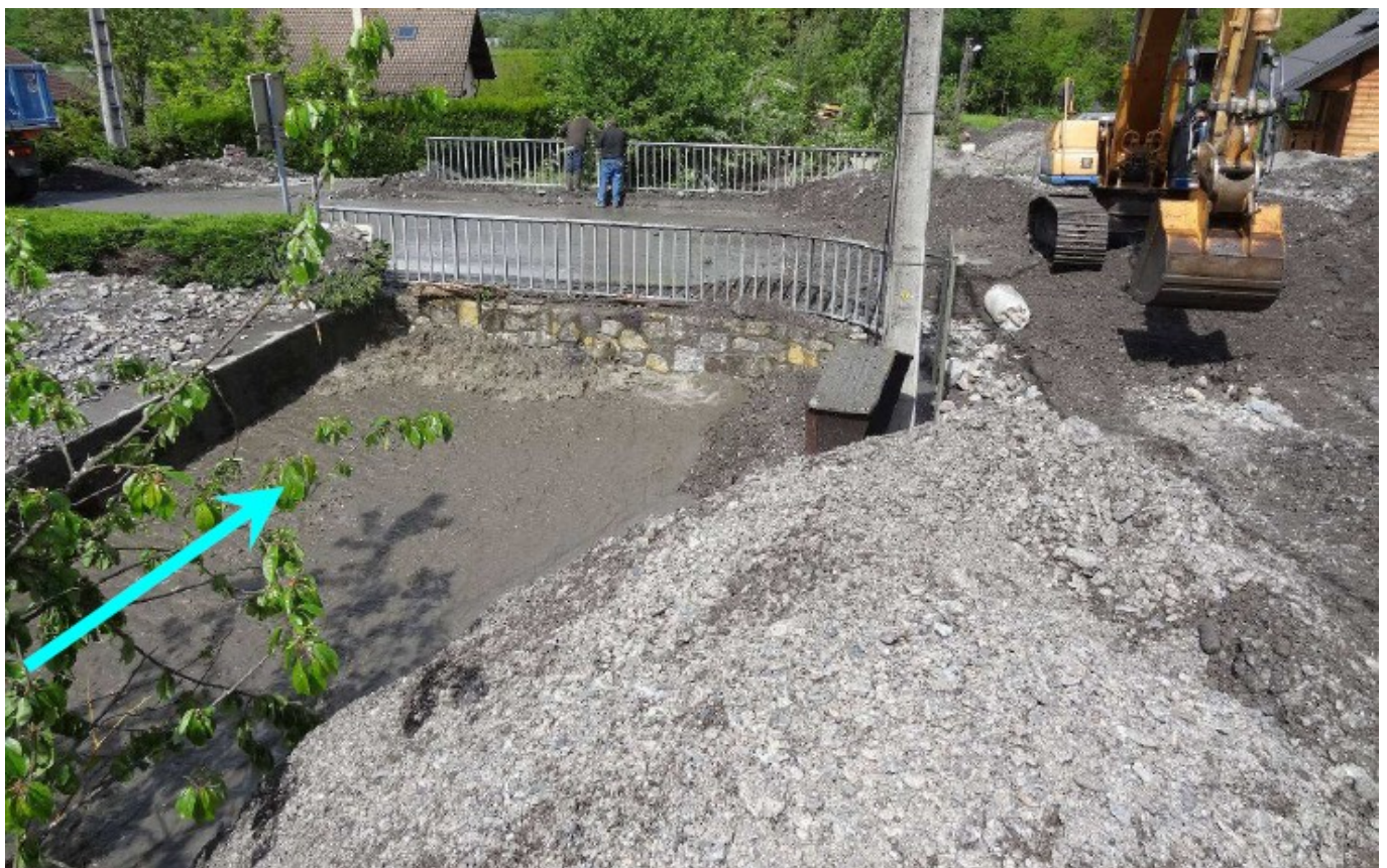
Figure II.11: Engrèvement du pont de la RD 925 vu depuis l'amont en 2015.
