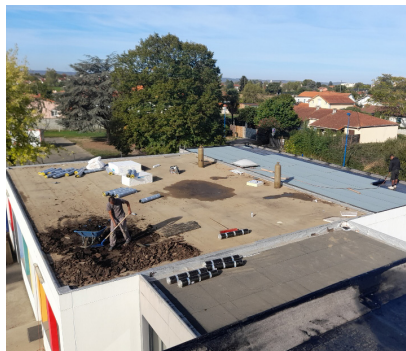
Rénovation de l'étanchéité et de l'isolation de la toiture du bâtiment des écoles des Cèdres.
