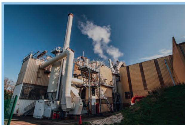
Une Unité de Valorisation Énergétique (UVE)
