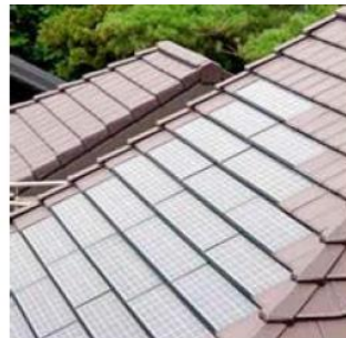
Ex. équipement posé sans respect de la toiture : interdit
