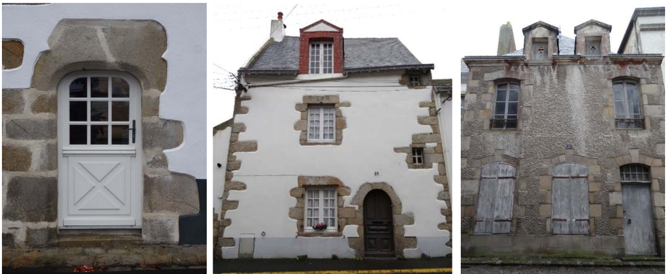
Enduits en surépaisseur aux contours « artistiques » ; enduit ciment sur maçonnerie traditionnelle
