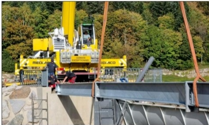
L'installation, ce lundi 9 octobre, des traverses qui supporteront la passerelle, laquelle enjambera sur 23 mètres le déversoir du barrage. Photos DNA/G.G.
