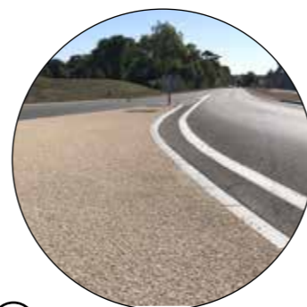
④ Résine sur enrobé résine de colori beige appliquée par zones sur enrobé existant
