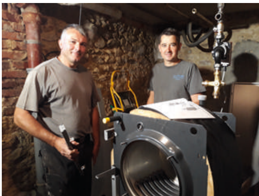
Une chaudière toute neuve !
