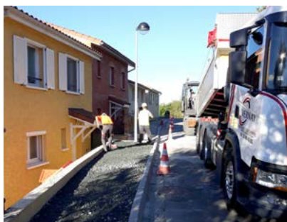
Trottoir rue de la colline
