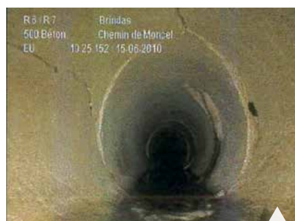
Exemple d'un réseau d'assainissement en béton cassé
